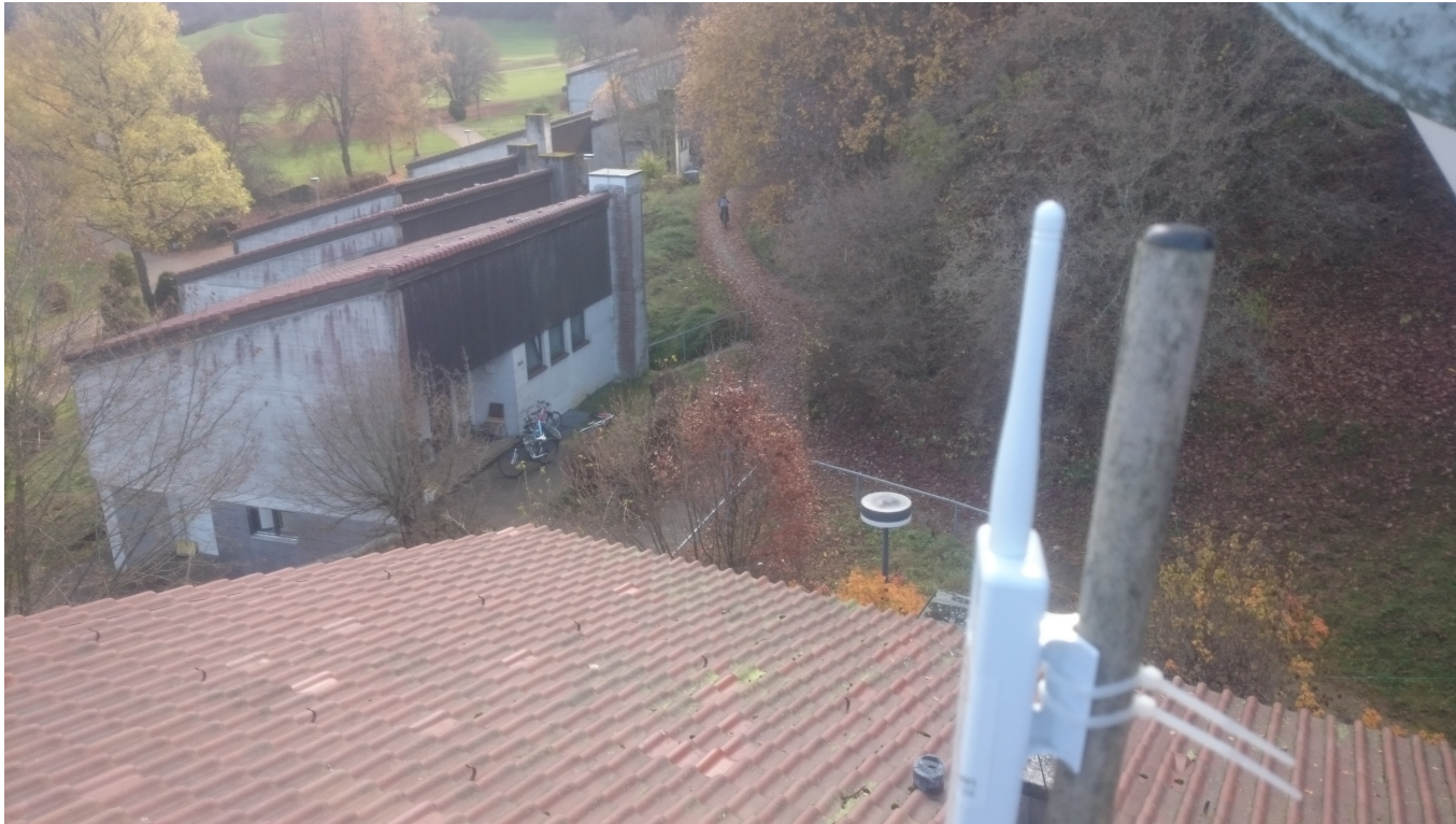
Richtfunkstrecke AP Ubiquiti Picostation M2-HP
